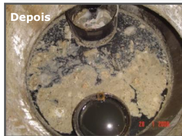
Caixa de gordura antes e após 15 dias do início da aplicação.
