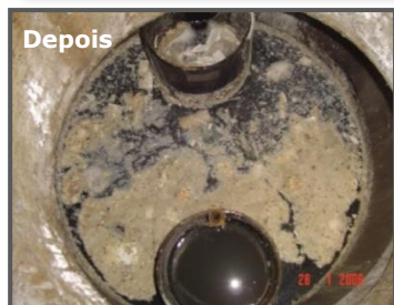
Caixa de gordura antes e após 15 dias do início da aplicação.
