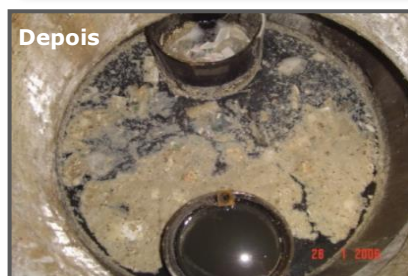
Caixa de gordura antes e após 15 dias do início da aplicação.
